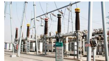
变电站无人值守监控
